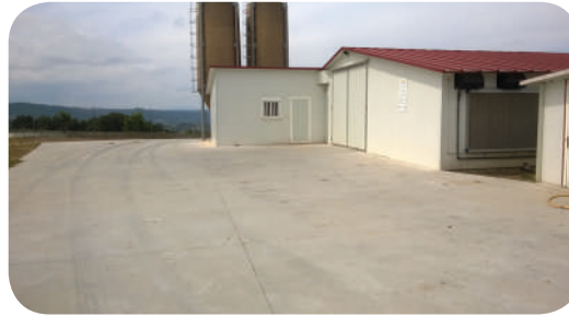
Superficie de hormigón en las entradas
